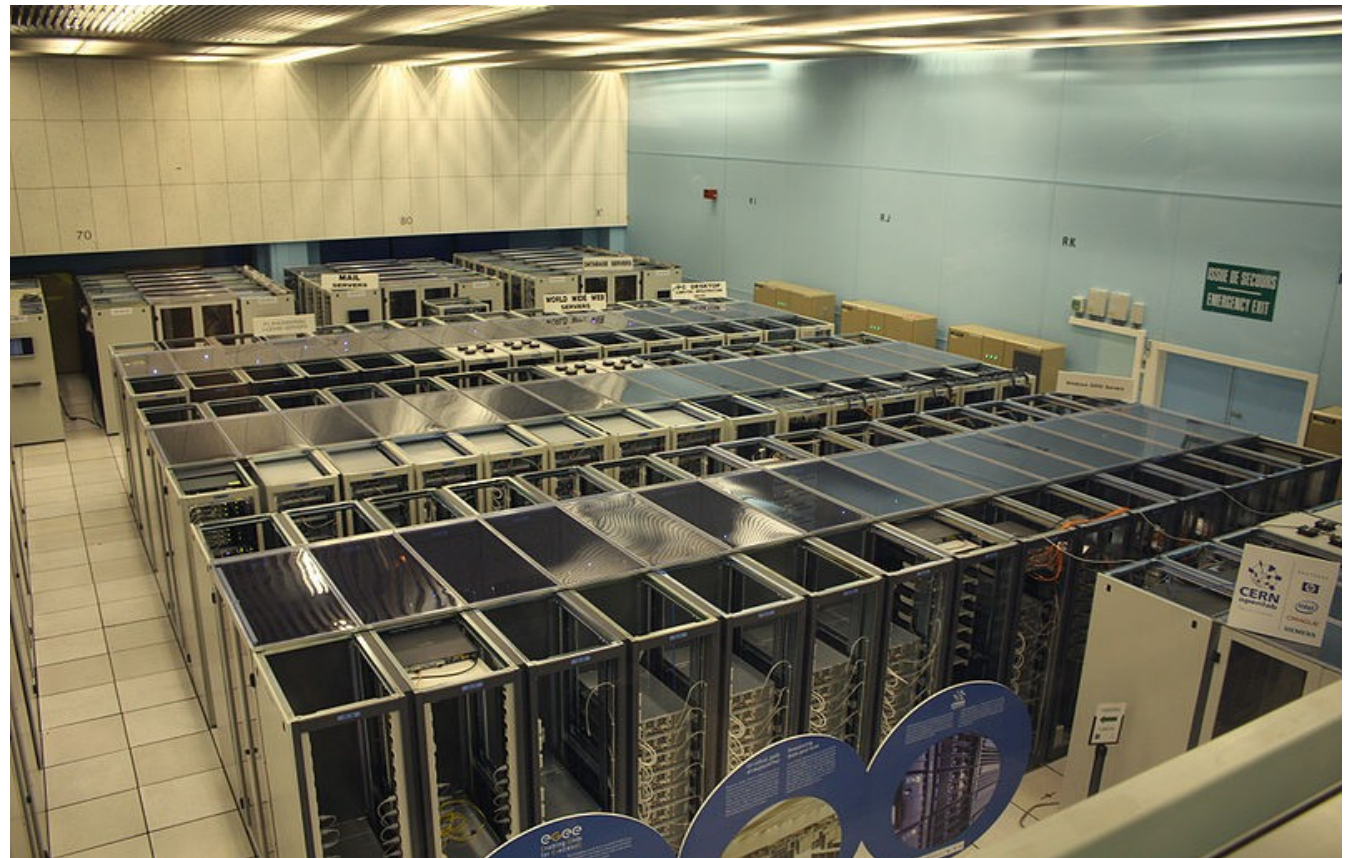
Datacenter du CERN
